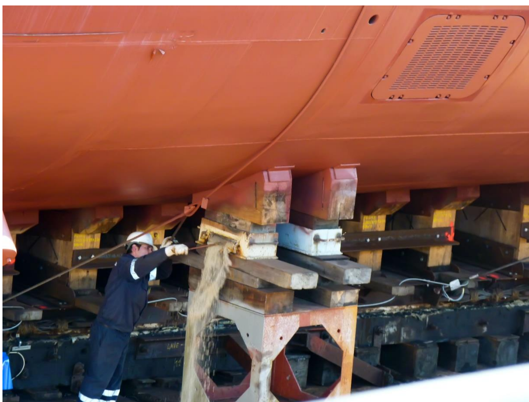
Operario actuando sobre una caja de arena (Fuente: EXPONAV)
